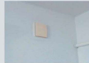
〈換気扇取付写真〉
